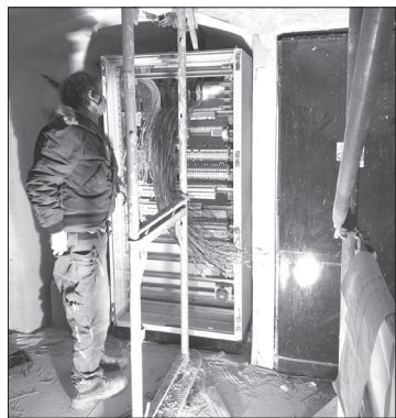
Nový elektrický rozvaděč v kapli sv. Anny
